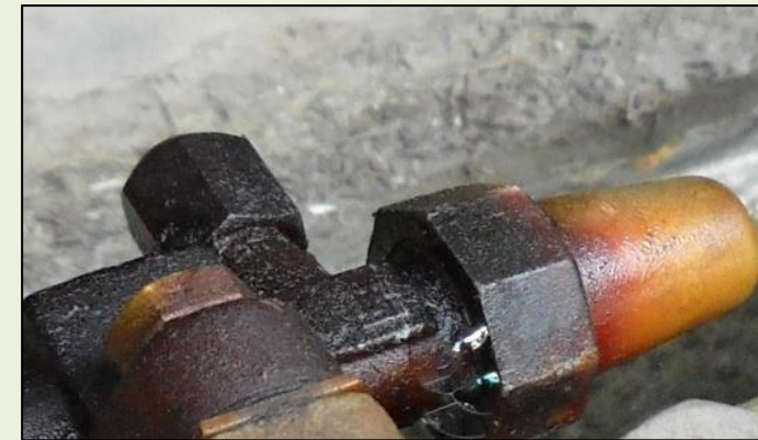
(写真)漏れ箇所
