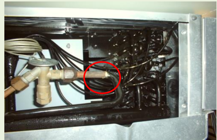
(写真)漏れ箇所
