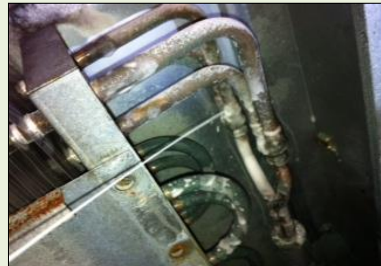
(写真)漏れ箇所
