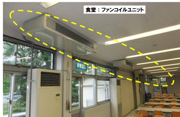
食堂ホールの空調補助として
