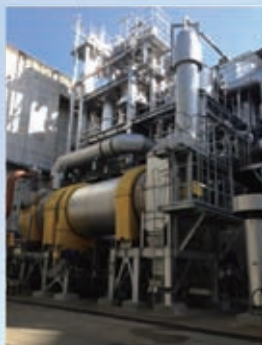
図 3-23 湖西浄化センター污泥燃料化施設
